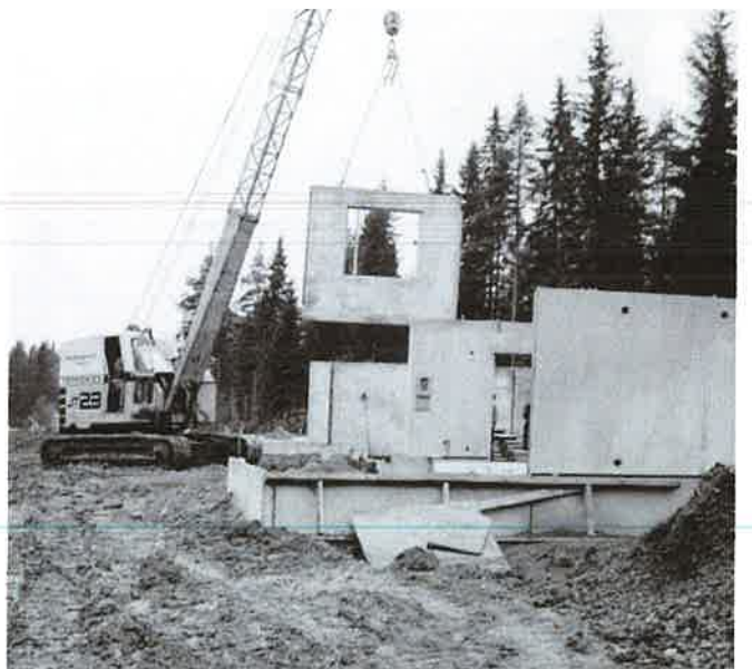
Ruotulan omakotitalot olivat maan ensimmäiset täyselementtirakenteiset pientalot. Parhaimmillaan yhden talon seinäelementit asennettiin viidessä tunnissa. (lähde: Aarre Mattisen valokuvakoelma / Rakennusliike Mattinen & Niemelä Oy)
